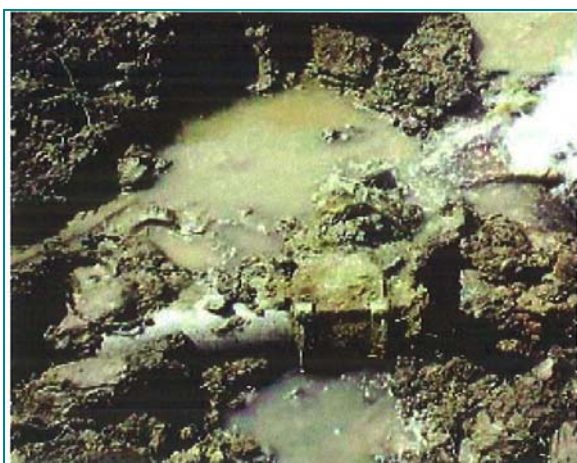
Il·lustració 13: Vista en detall d'una fuga d'aigua a una canonada de la xarxa d'abastament de Barcelona. Font: AGBAR
