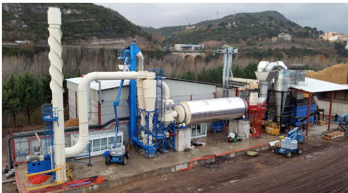
Nova planta d'assecatge d'Enerbío a les instal·lacions de Puig-Reig. (Foto: Josep Soler Prats.)
