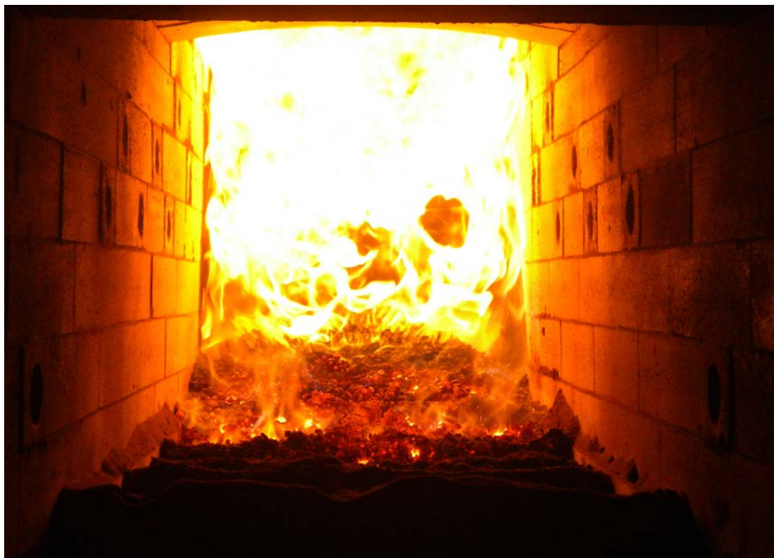
Cambra de combustió d'una caldera de pèl·lets de 250 kW.
