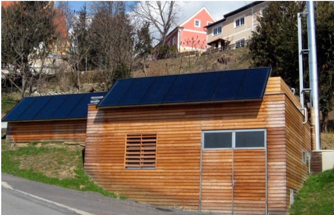
Un exemple d'un petit projecte de contractació de fusta de combustió a Estíria (400kW). (Font: Cambra de Silvicultura i Agricultura.)
