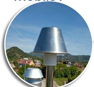
Presa de mostra gasos (NO x i O 3 )
