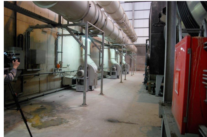
Conductes de ventilació d'una planta de compostatge Font: AMB
