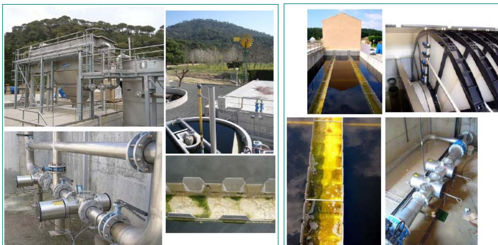
Il·lustració 10: Vistes en detall dels tractaments d'aigua regenerada de L'EDAR a Tossa de Mar.
