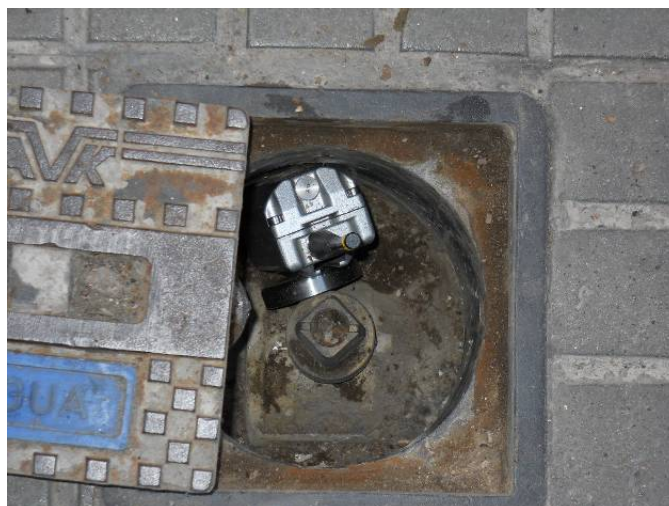
Il·lustració 21: Equips pre-localitzadors de fuites (Sepem) instal·lats en el municipi de Rubí. Font: AGBAR
