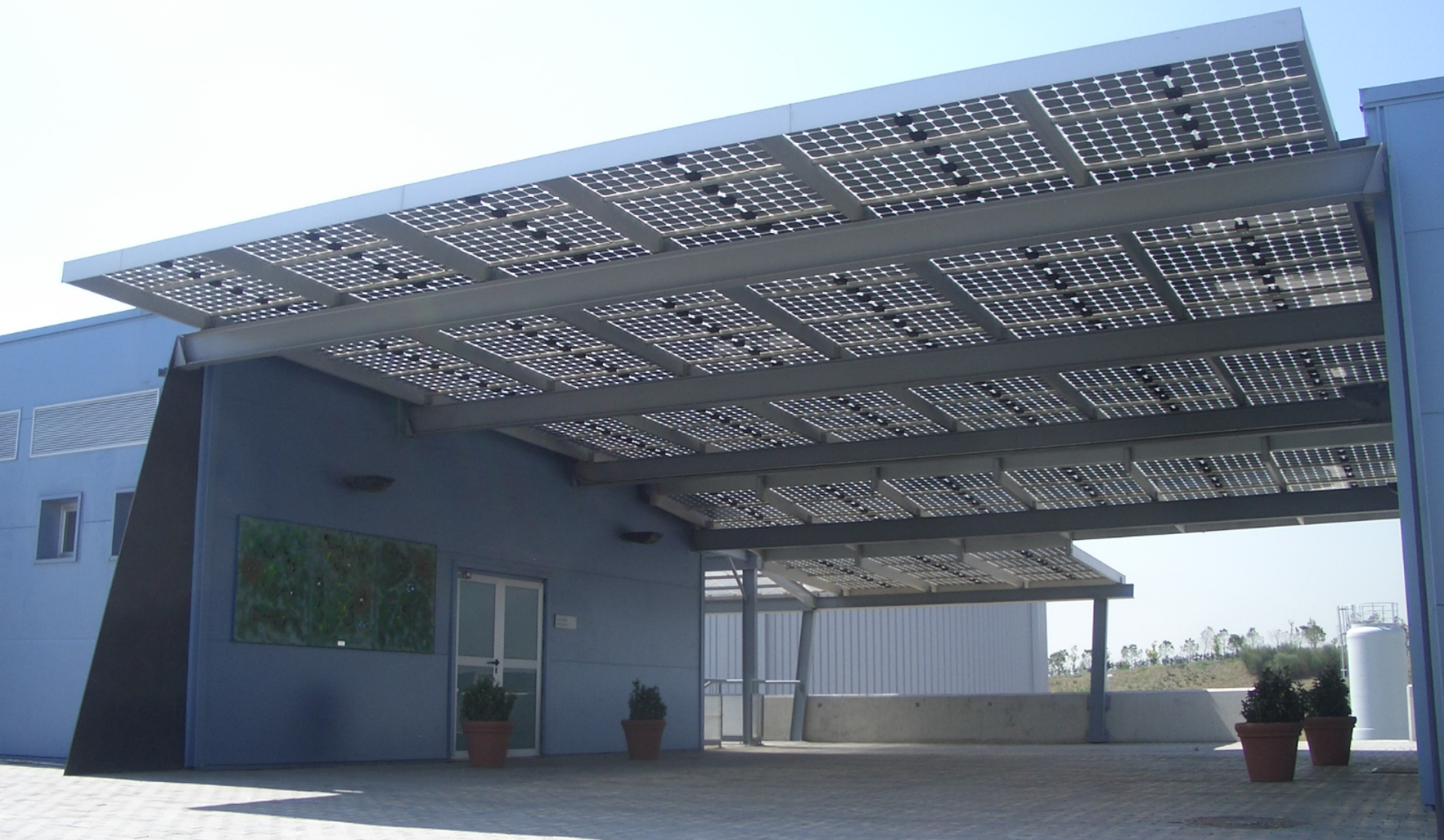
Ecoparc, Montcada i Reixac – 18,15kWp
